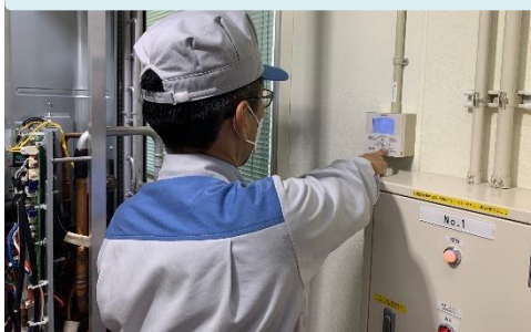
運転データ計測 (リモコン)
